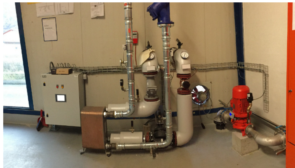
Sous-Station Nestlé Waters
